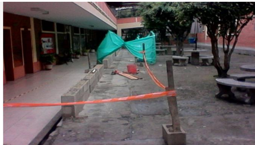
FALTA DE SEÑALIZACIÓN EN OBRAS
