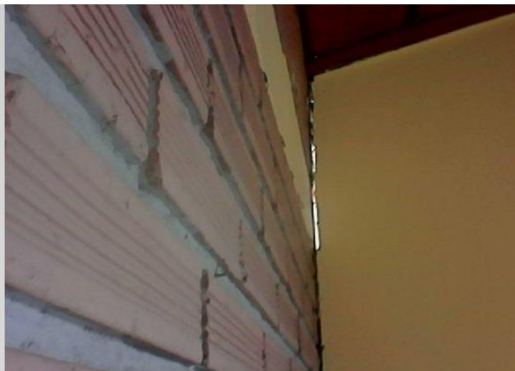
FISURAS PARED AYUDAS AUDIOVISUALES
